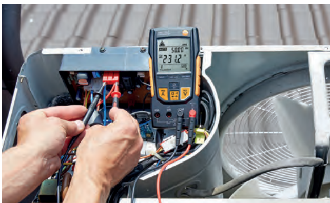
Měření napětí na venkovní chladicí jednotce s testo 760 .
