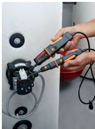
Měření napětí na kotli.
