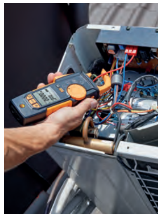
Připojení klešťového multimetru k venkovní chladicí jednotce.
