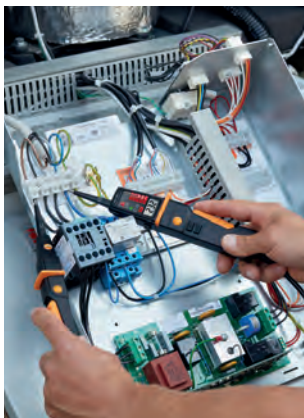
Měření napětí na kompresoru.
