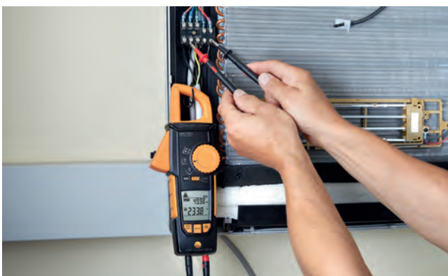
Měření napětí na klimatizační jednotce s testo 770 .
