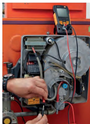
Příprava měření ionizačního proudu
