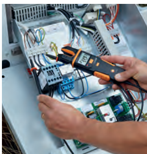
Měření napětí na kompresoru.
