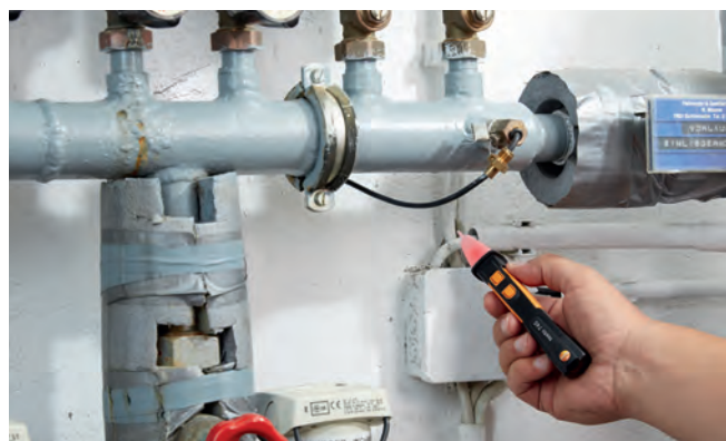
Kontrola napětí na rozvaděči s testo 745 .
