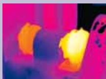
Nevyrovnané zatížení třífázového rozvaděče
